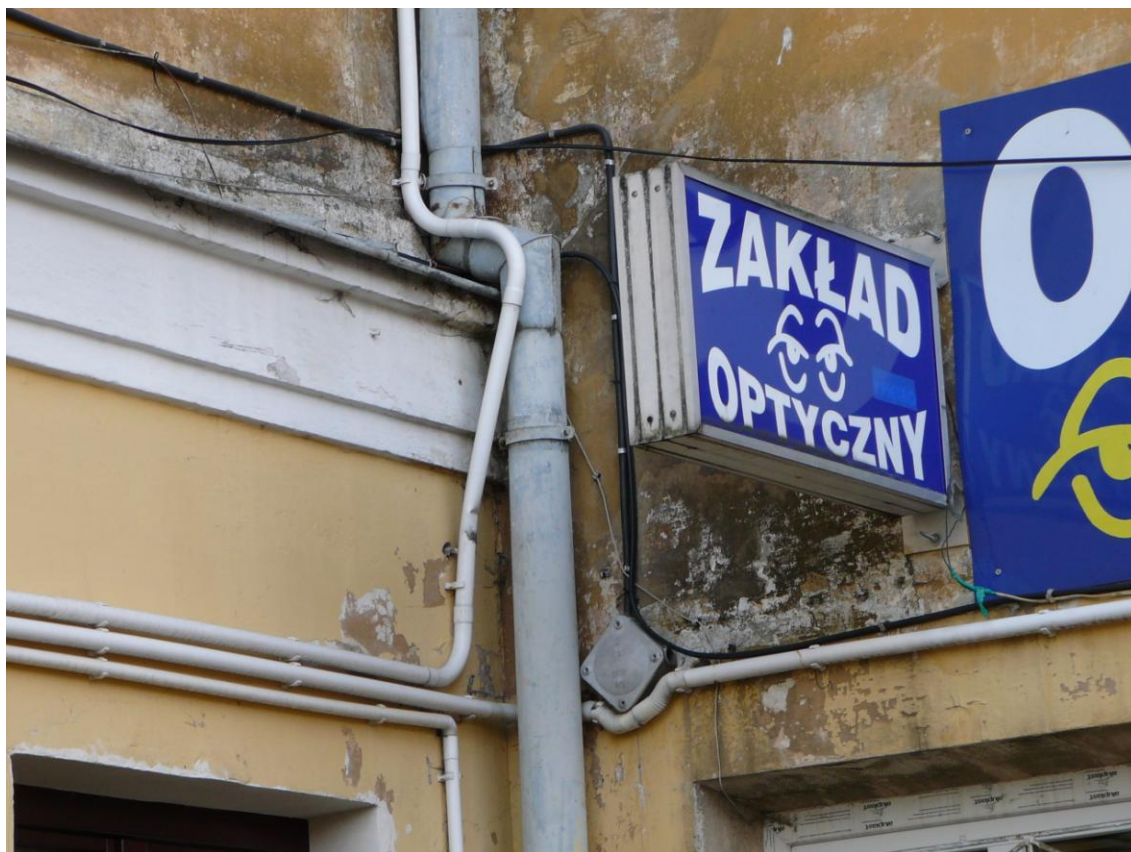
Widok skutku zawilgocenia naroża ścian
