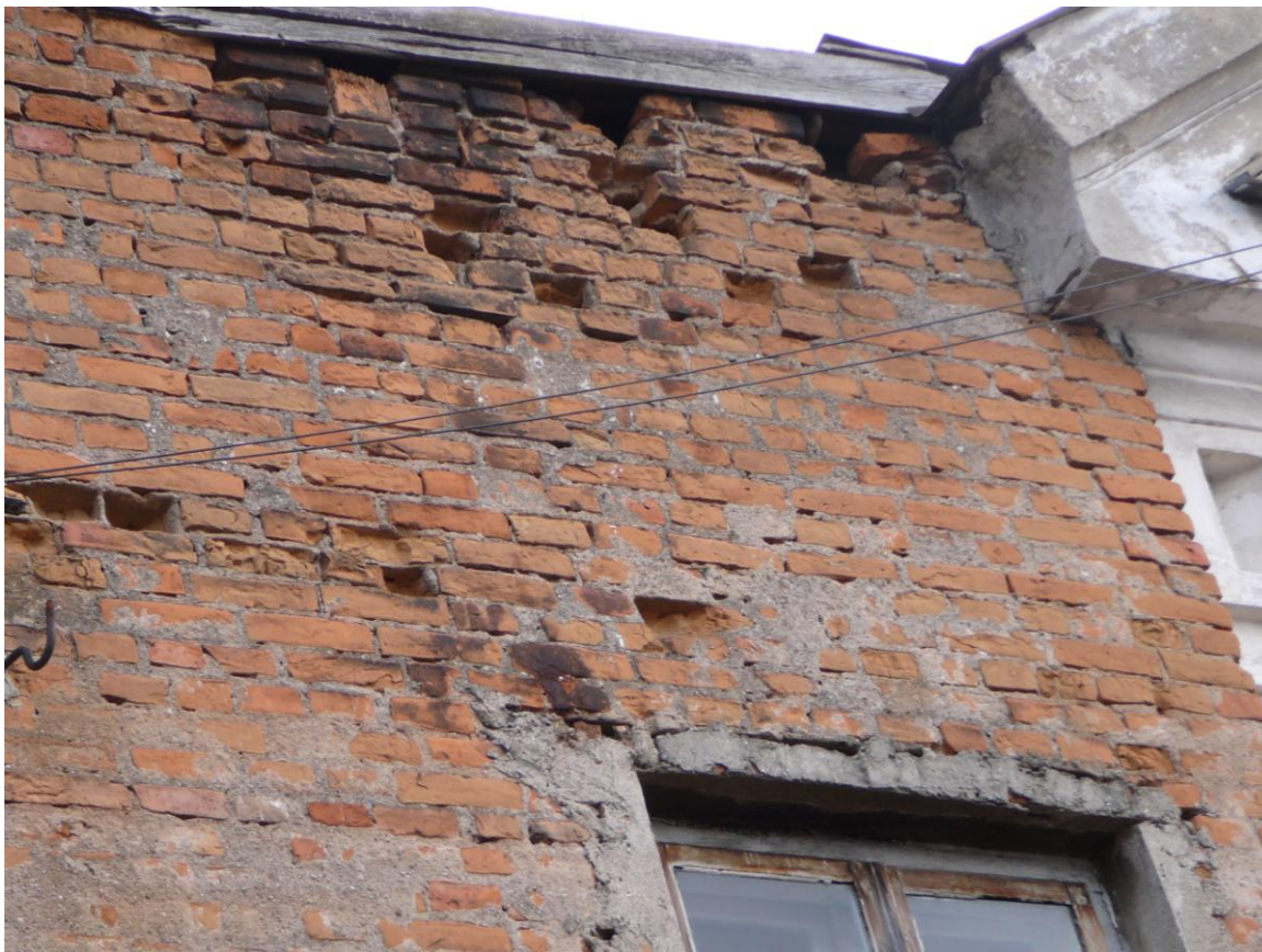
Ubytki cegieł w ścianie zewnętrznej
