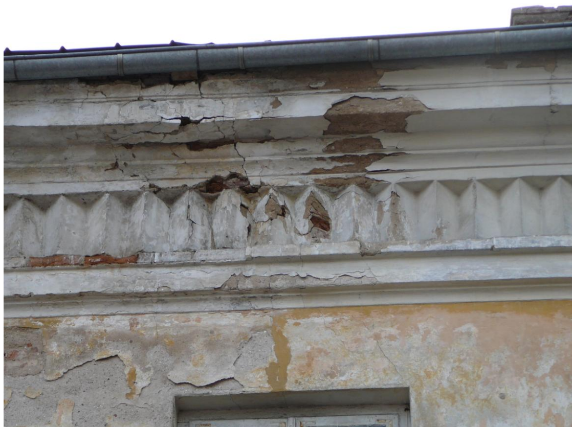
Uszkodzenia gzymsu od wody opadowej
