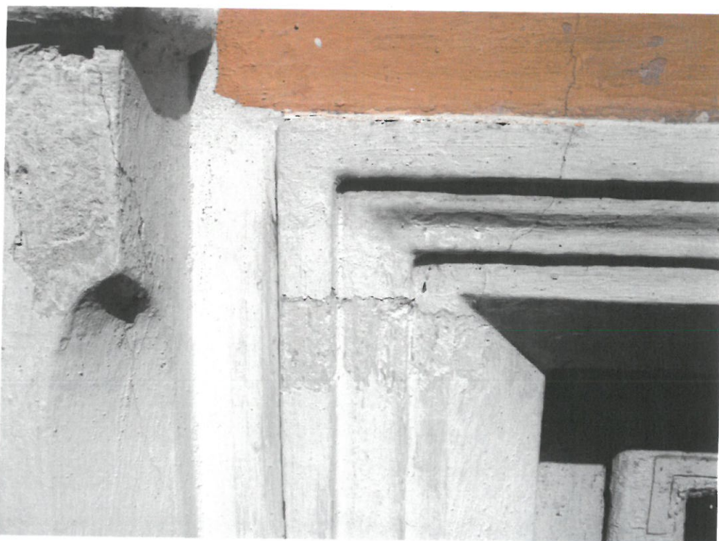
ZDJ. 7 | 8 SOKÓŁKA. KAMIENICA PRZY UL. PIŁSUDSKIEGO 1. ELEWACJA POŁUDNIOWA. ODKRYWKI W OBRĘBIE OPASKI OKIENNEJ— WIDOCZNE ŚLADY NAJSTARSZEJ, BIAŁEJ WARSTWY
