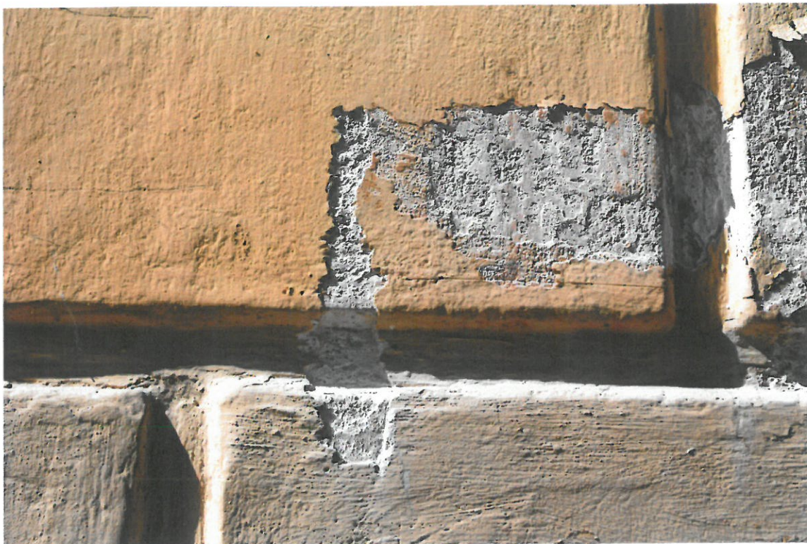
ZDJ. 11, 12 SOKÓŁKA. KAMIENICA PRZY UL. PIŁSUDSKIEGO 1. ELEWACJA POŁUDNIOWA. ODKRYWKI W OBRĘBIE BONIOWANIA – WIDOCZNE ŚLADY OCHRY
