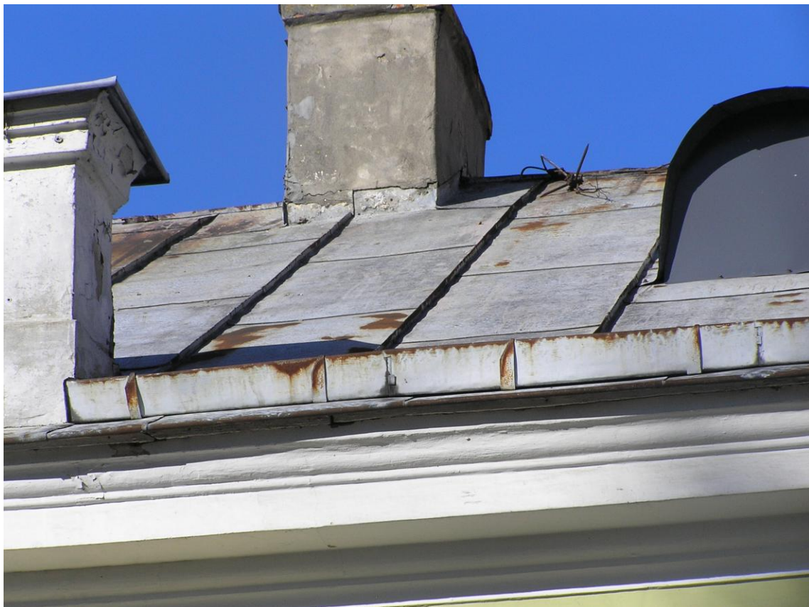
Fot.5. Widok stanu pokrycia dachowego. Widoczne ogniska korozji.
