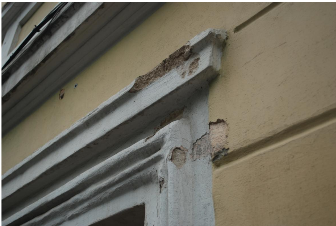
Fot.8. Widok uszkodzeń nadproża.
