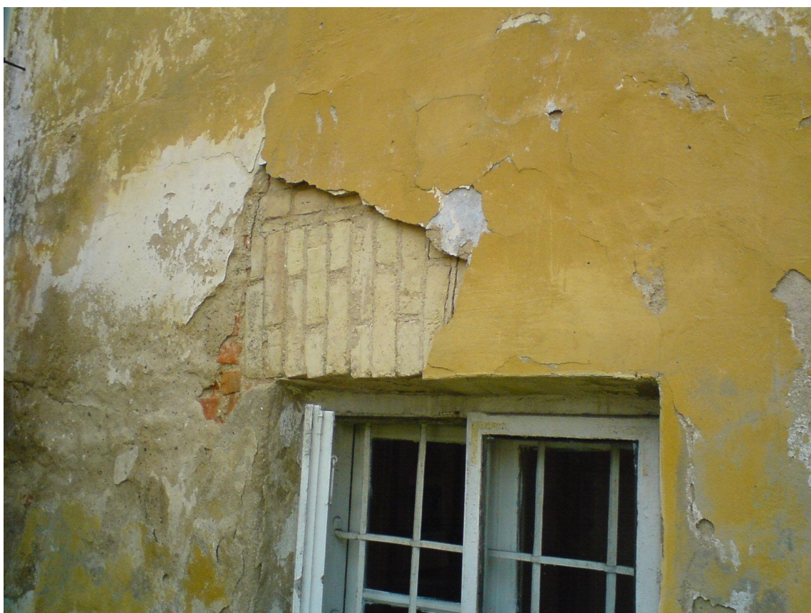
Fot.6. Widok nadproża okiennego. Widoczne rysy.
