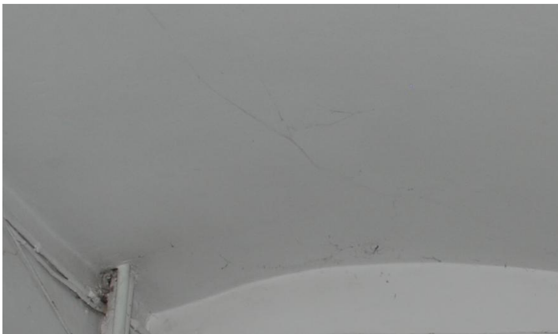
Fot.10. Widok stropu. Widoczne rysy sklepienia ceglanego.
