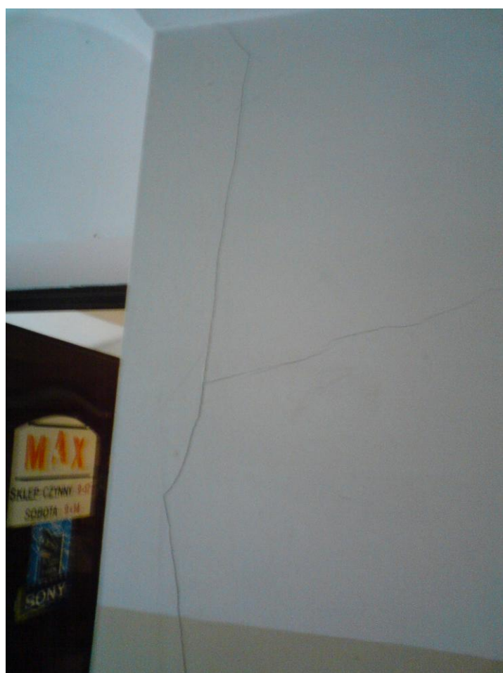
Fot.12. Widok ściany. Rysy pionowe i poziome.
