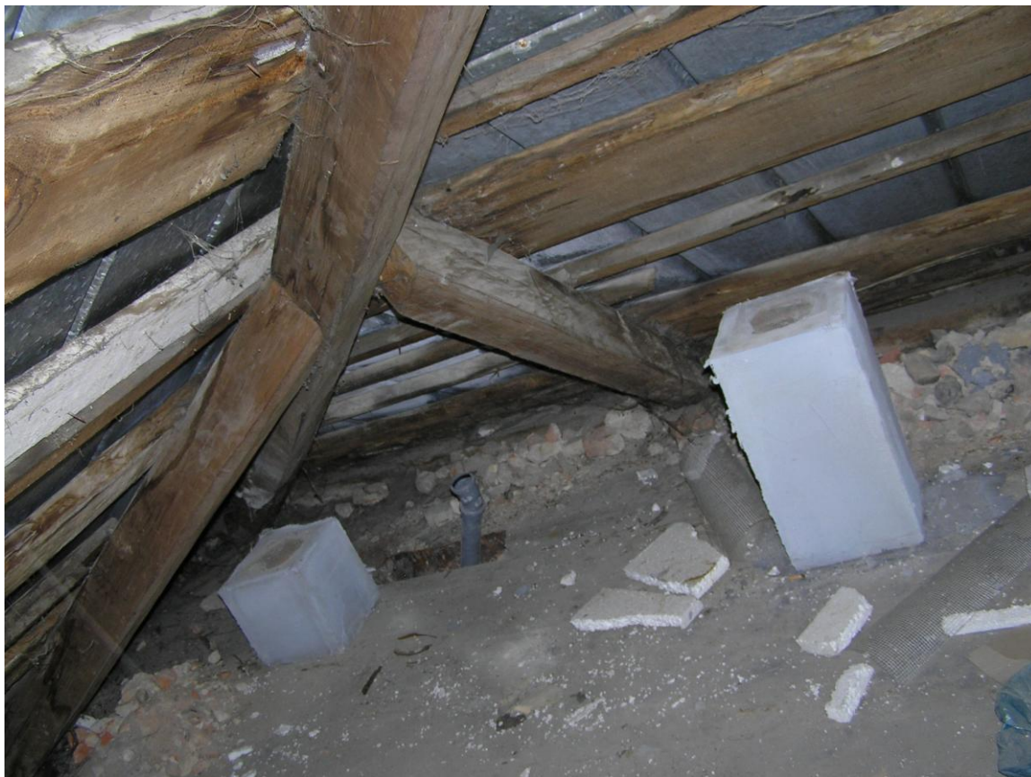
Fot.15. Więźba dachowa. Krokiew narożna. Widoczna degradacja ołączenia spowodowana wodą opadową z dachu.
