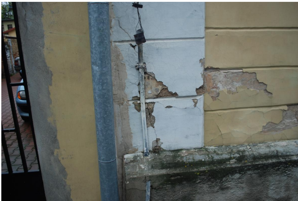
Fot.7. Widok degradacji ściany w narożniku.
