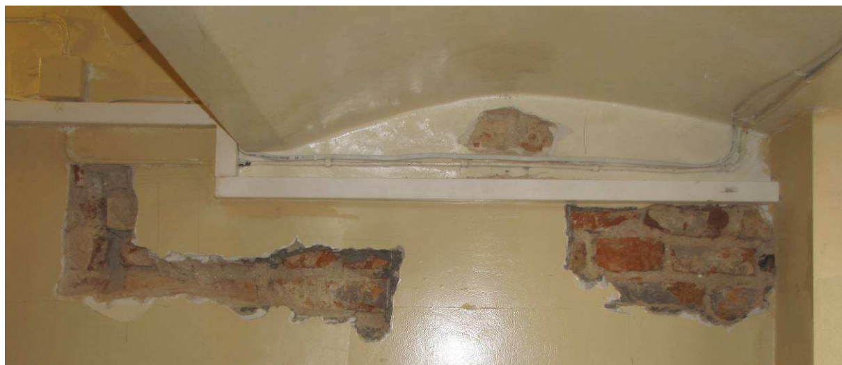
Widok fragmentu dawnej zachodniej części elewacji północnej korpusu głównego z lokalizacją odkrywek stanowiska „B”
