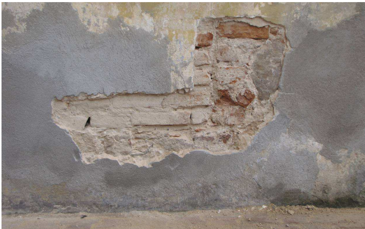
Odkrywka nr 3 ze stanowiska „A” - prawy narożnik dawnego otworu na wysokości parapetu.
