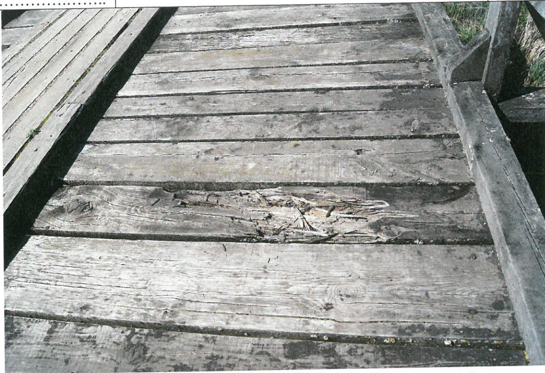
Fot. 4. Korozja biologiczna materiału oraz widoczne liczne pęknięcia pokładu drewnianego
