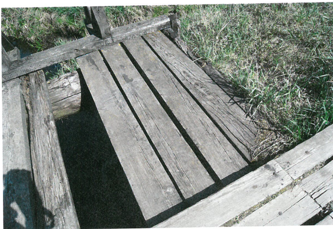
Fot. 5. Ubytek materiału belki drewnianej pokładu drewnianego
